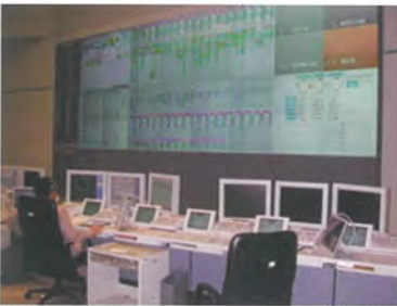
消防通信指令システム更新
