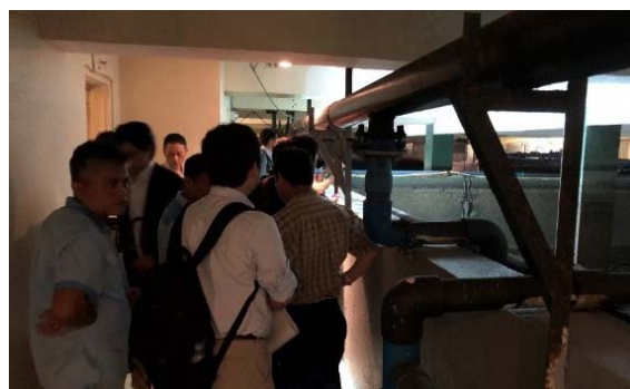
Jpark ホテルの排水処理設備
