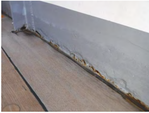
著しい腐食が見られたフード側壁基部
