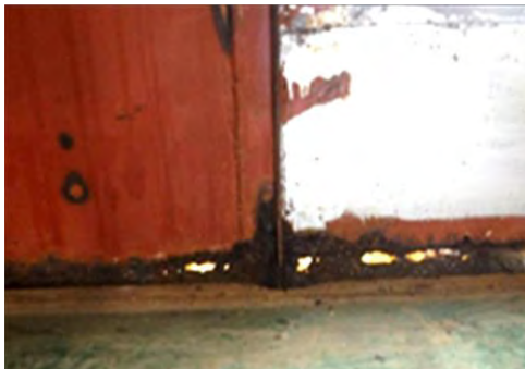
破孔が見られた士官居住区エントランス側壁基部
