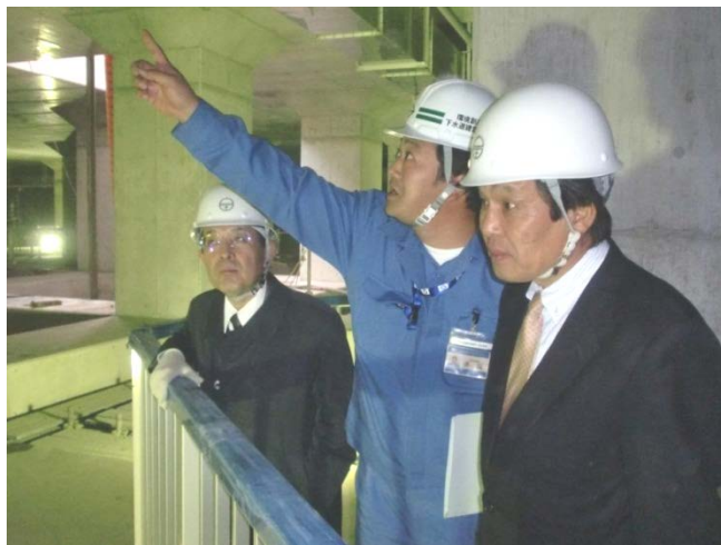
舞岡川遊水地建設工事における地下滞水部の進捗状況を確認する監査委員
