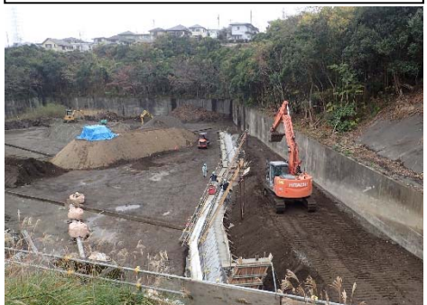
既設雨水調整池改良 (本郷台第一雨水調整池：栄区本郷台五丁目)
