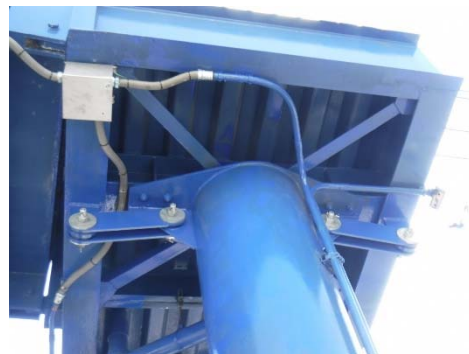
狩場第三歩道橋(保土ヶ谷区):落橋防止装置 平成31年3月完成
