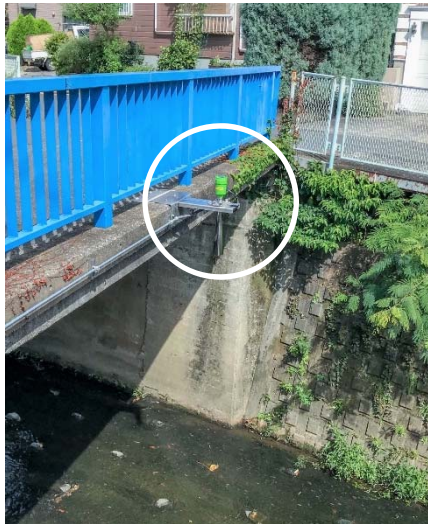
令和2年度に新設した水位計 (港南区 御所が谷橋 (準用河川日野川))
