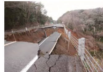
令和6年能登半島地震の道路被害のと里山海道(石川県ホームページから)
