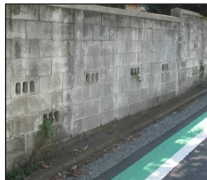
ブロック塀例
