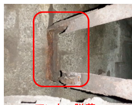
アンカー脱落
