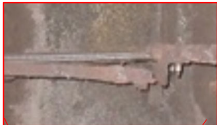
電らん棚折損
