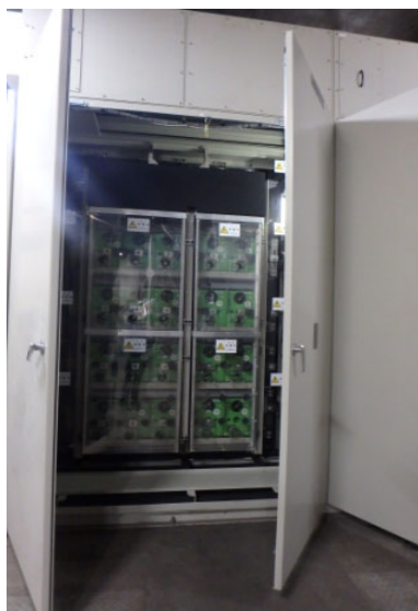
回生電力貯蔵装置(蓄電池盤)
