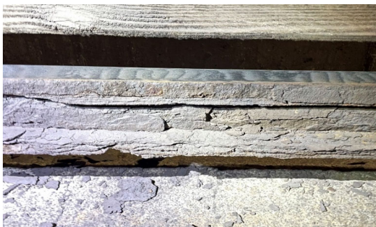
腐食したサードレール
