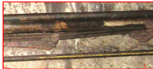
電らん棚腐食による
