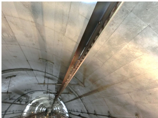
局部摩耗が発生している剛体電車線
