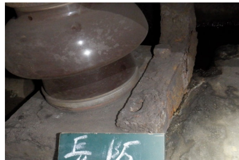
腐食した腕金
