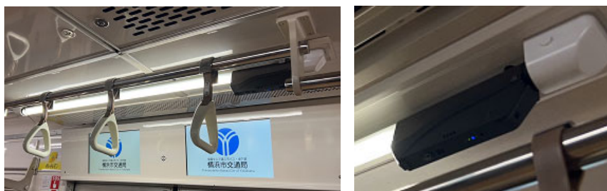
<3000S形車両に設置した防犯カメラ>
