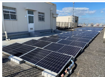
太陽光発電設備
