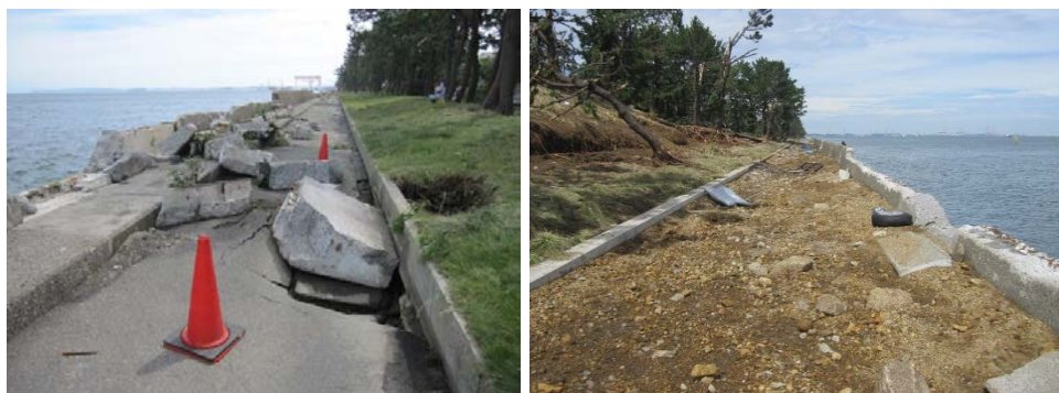
護岸の倒壊状況(福浦・幸浦地区)
