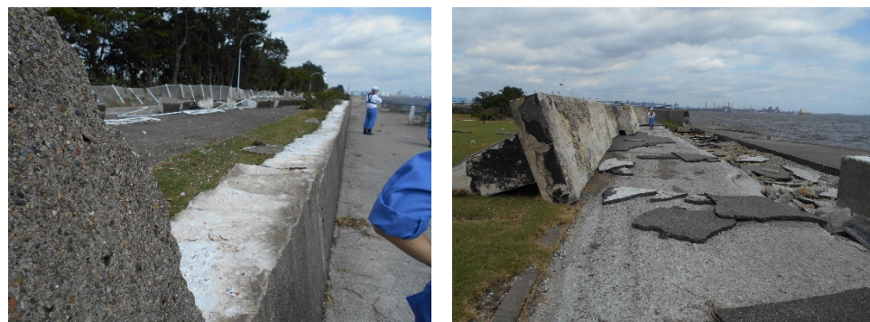
護岸の倒壊状況(本牧地区)
