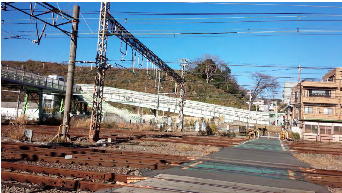
写真2 老朽化したスロープ周辺
