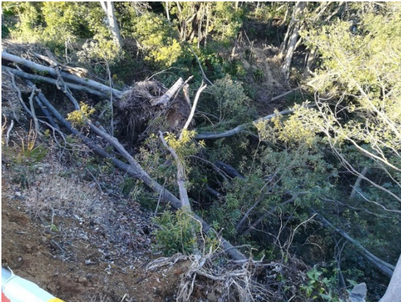
施工前(土砂崩れ)
