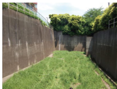
片倉町雨水調整池
