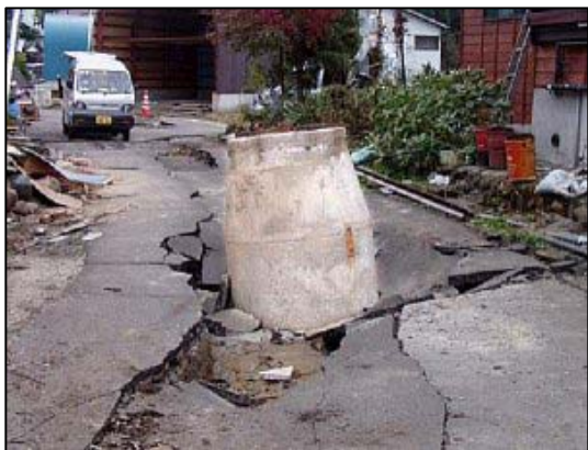
管路施設（下水道管きょ）の被害状況
