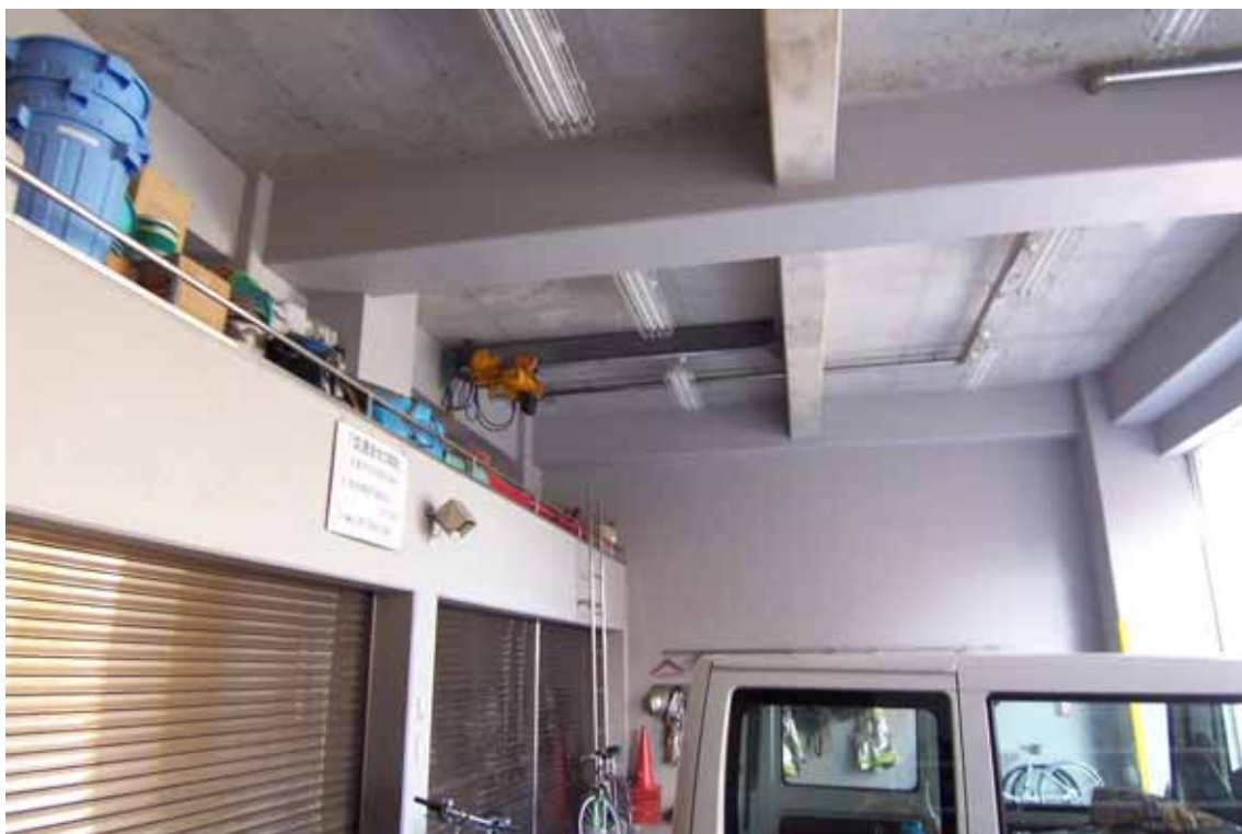
消防車庫内天井部のホイスト及びホイストレール( )
