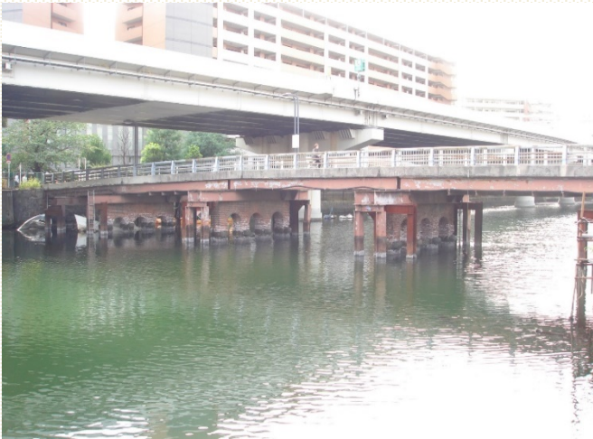
架替前の新浦島橋を北東側から望む。レンガ造りの橋脚の老朽化のため、桁はH鋼で補助的に支えている(平成24年(2012)撮影)
