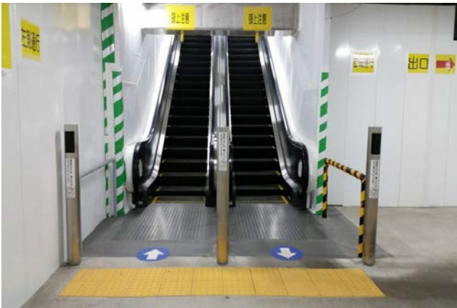
写真⑤ エスカレーターの設置状況
