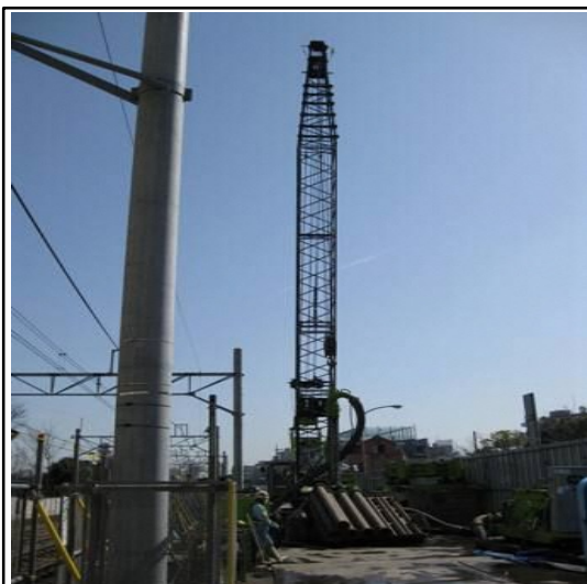
写真-② 天王町1号～2号踏切間南側の 杭施工風景（3月末までに17本施工予定）
