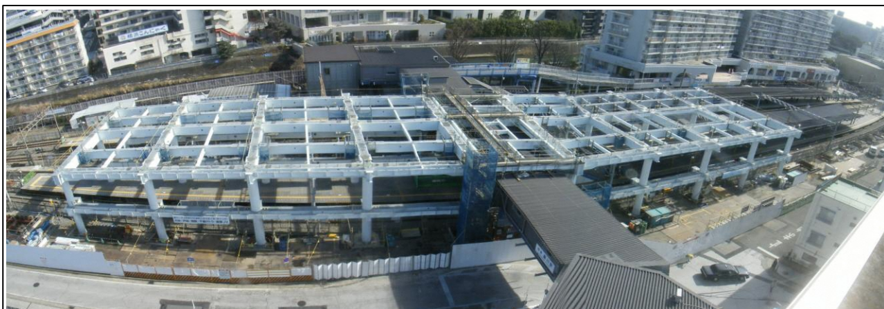
写真-② 星川駅鉄骨架設状況 (全体) (南側から北側を望む)
