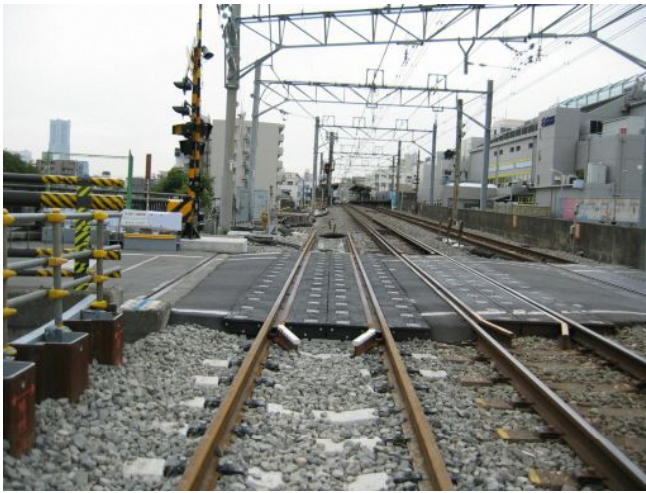
写真一① 天王町1号踏切付近の起点方切替え箇所 (平成19年10月撮影)
