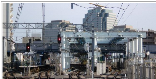
写真-① 星川駅鉄骨架設状況 (海老名方から横浜方を望む)
