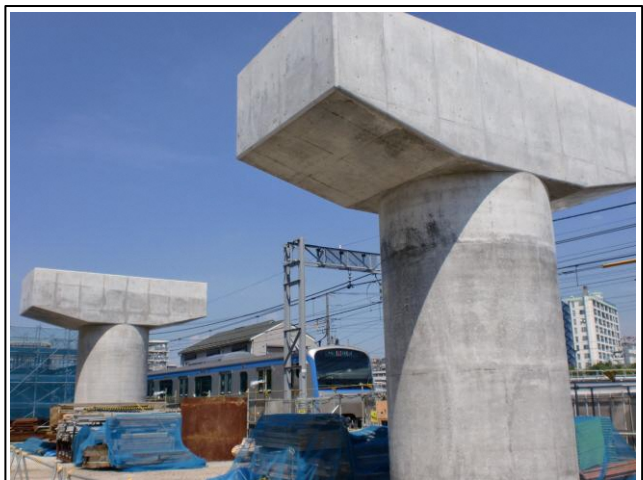
写真-③ 星川1号～2号踏切間橋脚施工状況 (海老名方を望む)
