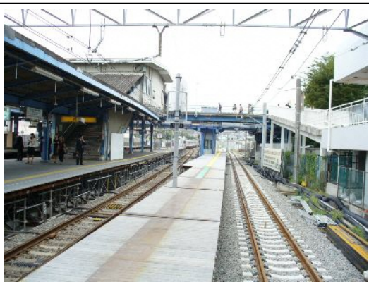
写真一④ 施工中の星川駅仮設上りホーム (平成19年10月撮影)
