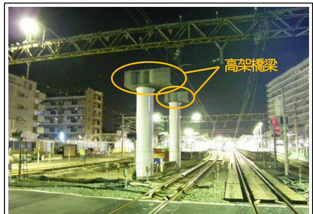
写真-② 天王町3号踏切の高架橋梁の架設状況 （天王町3号踏切から海老名方を望む）
