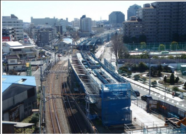
写真-② 星川第2架道橋架設状況(現況) (海老名方から横浜方を望む)
