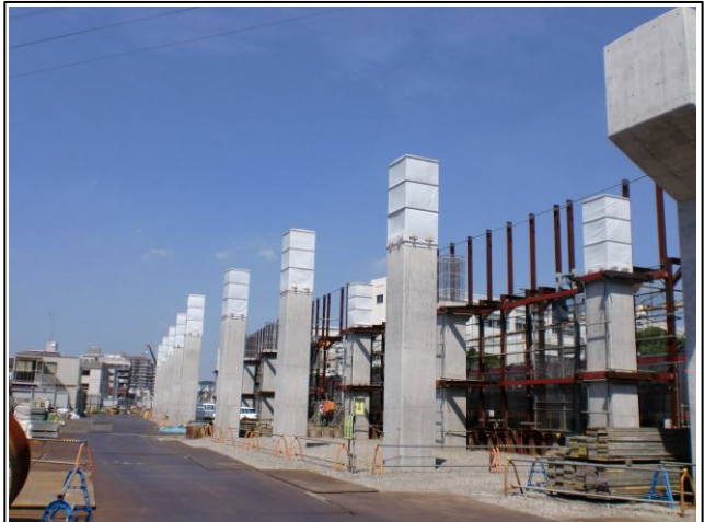
写真-① 天王町2号～3号踏切間橋脚施工状況 (海老名方を望む)
