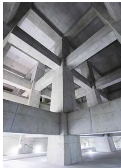
公園の地下に設置された雨水調整池
