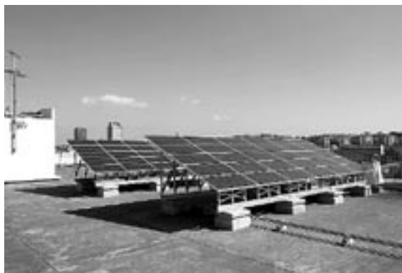
■南台小学校太陽光発電システム
