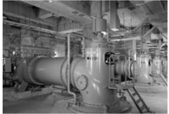
■主ポンプ 樽町ポンプ場（鶴見区）
