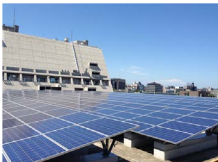
神奈川水再生センター太陽光発電設備
