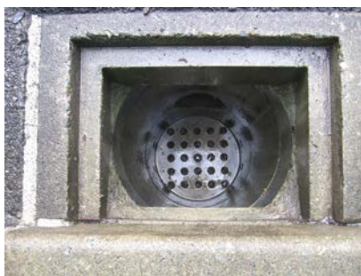
雨水浸透ます
