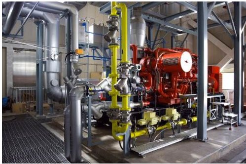
消化ガス発電設備
