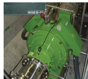
今井配水池小水力発電設備
