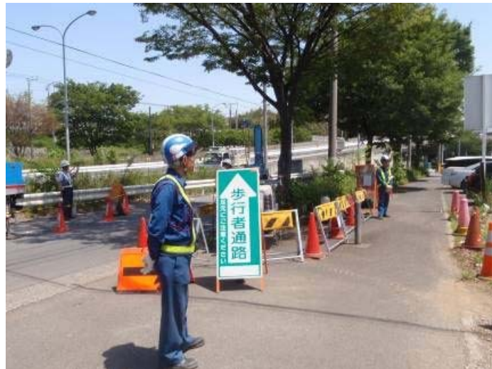
写真 4-11 環境保全のための措置の実施状況（迂回案内（通行者の誘導））
