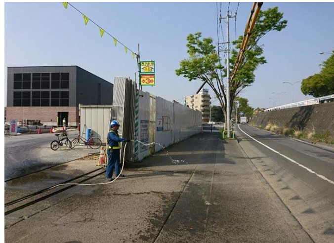
写真 4-2 環境保全のための措置の実施状況（工事現場周辺での散水）
