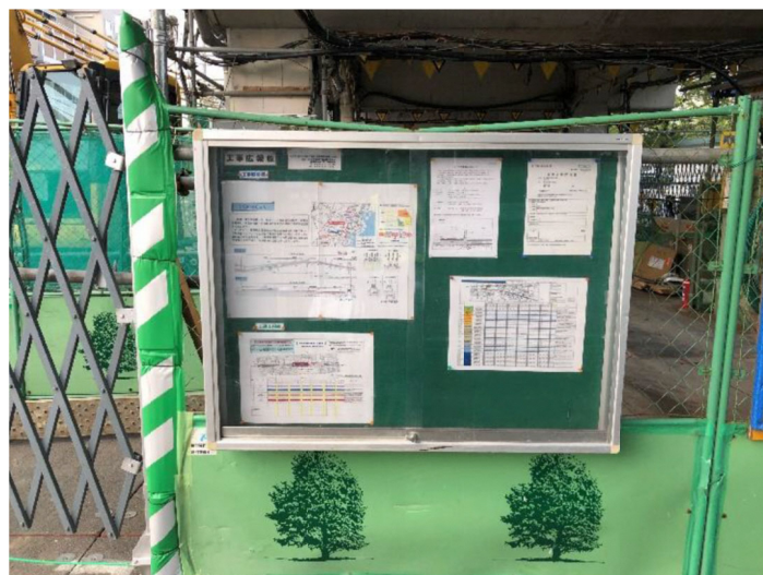
写真 2.4.4-8(1) 環境保全のための措置の実施状況（工事計画の周知：工事案内掲示板①）
