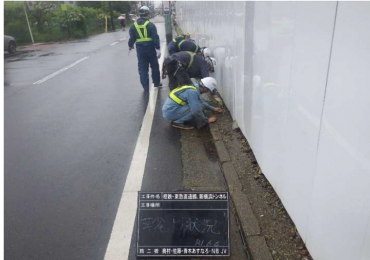
写真 2.4.4-2(2) 環境保全のための措置の実施状況（工事現場付近での清掃）
