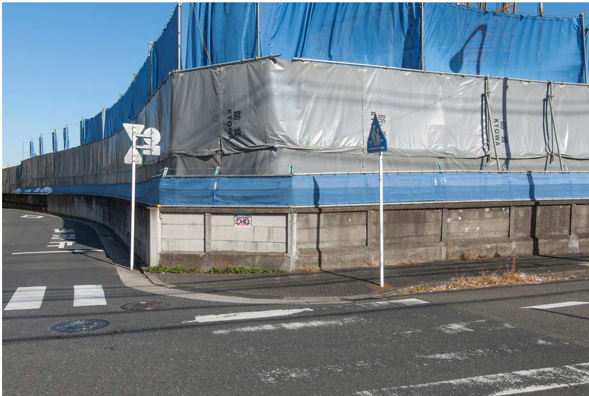
図 5-2(11) 建設前の状況写真（地点 17：西側敷地南西側（北方向を眺望））〈本編 p.6.11-33 の図 6.11-3(17) 拡大版(焦点距離 35mm 相当の画角)〉
