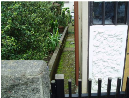
写 隣接地との離隔不足
