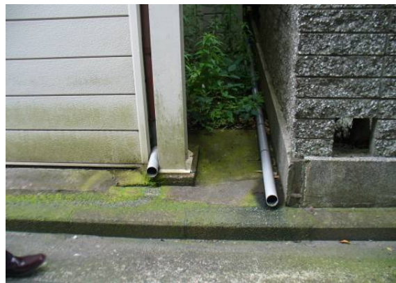
写 雨どいの接続不備
