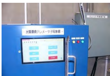
自動計測機から市へ水質データを送信する装置
