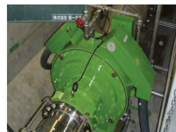
今井配水池小水力発電設備
