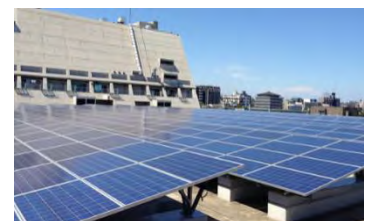
神奈川水再生センター太陽光発電設備
