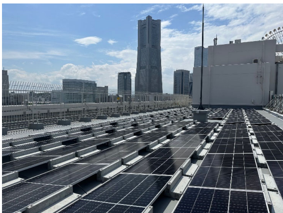
脱炭素先行地域事業で整備した 太陽光パネル (横浜ワールドポーターズ)
