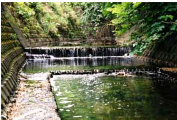
写真3 D33（ST.8）最下流の連続2段の落差工、水叩き部が浅いコンクリート平面、落差間隔が5mである。ヌマチチブはこの下まで出現した。
