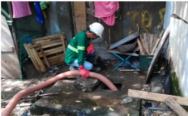
写真－1 セブ都市圏のセプティックタンク
