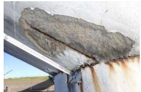
写真－ 2 P2 橋脚鉄筋露出
