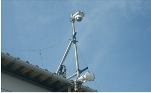
写真-2 現場に設置したカメラ
