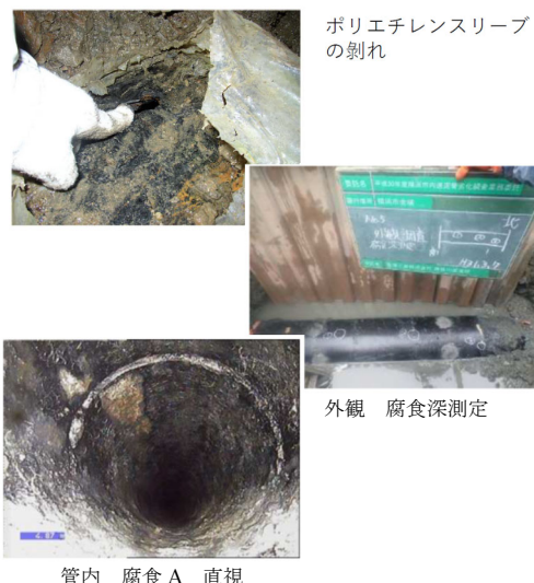
写真－１ 送泥管の劣化状況
