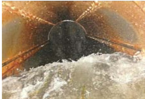
写真4 装置下流側（干潮時）
