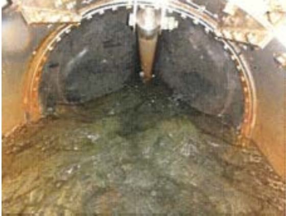
写真3 装置上流側（干潮時）
