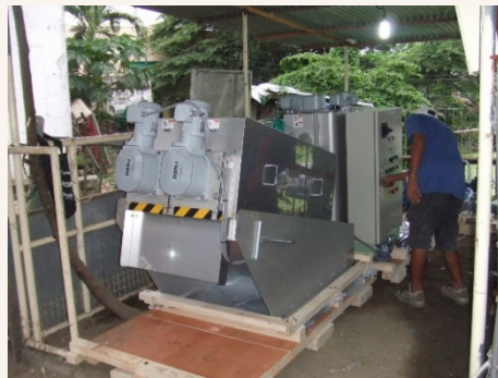
導入した汚泥脱水機
