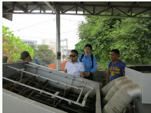
会員企業が導入した汚泥脱水機の確認
