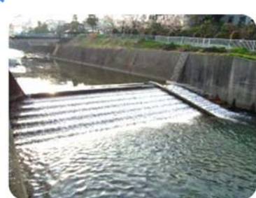
水路式魚道の整備 帷子川 (横浜市旭区)
