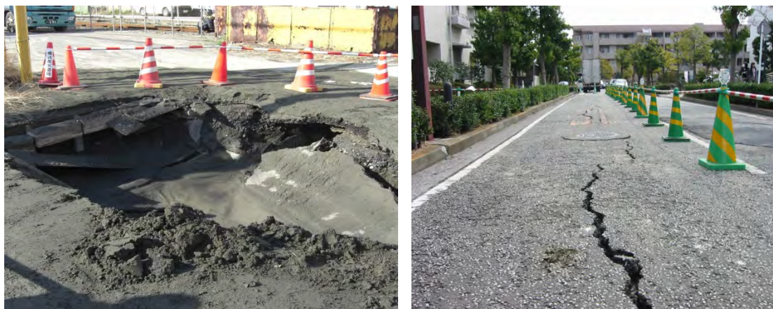
図 2-28 東日本大震災後の市内の被害状況
