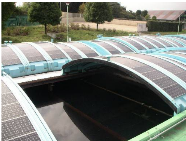
「小雀浄水場ろ過池・ ろくがい 覆蓋型太陽光発電設備」
