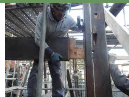
解体保管状況（軸組） 部材は一本ずつ手壊して解体しました
