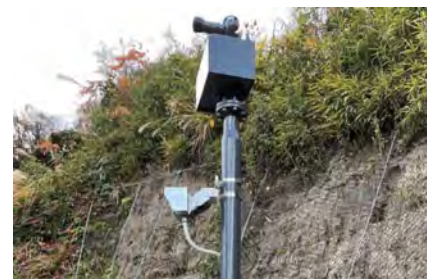
防災設備の設置（下：炎検知器、上：放水銃） 本工事では、自動火災報知設備、炎検知器、放水銃等防災設備・防犯設備を整備します
