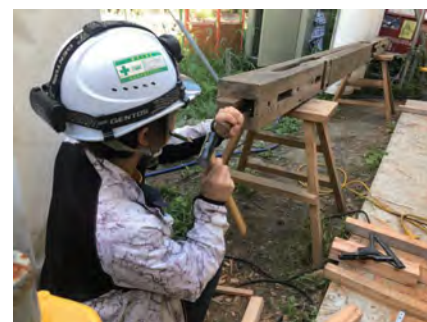
部材補修状況（柱材） 解体した部材は一本ずつ確認し、破損・腐朽している箇所を補修します
