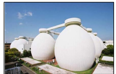
バイオマス発電（下水処理施設）
