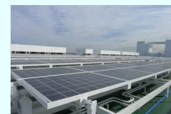
太陽光発電システム
