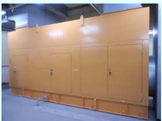
非常用電源施設
