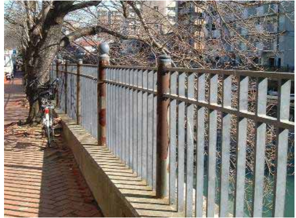
手すりの塗装が剥げ、サビが発生している。
