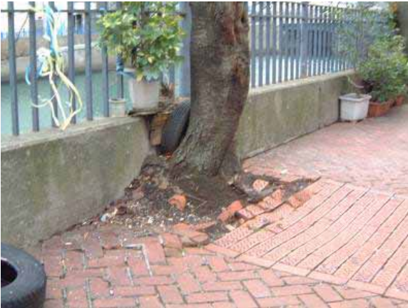
桜の根元の舗装に盛り上がりやひび割れが生じている。周辺には個人の鉢植えの植物が見られる。
