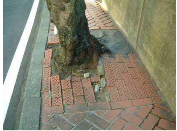
歩道幅員が狭い。 桜の根元の舗装に盛り上がりやひび割れが生じている。
