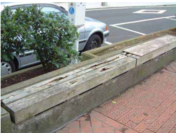
植栽ますと一体型のベンチ。座面の木にひび割れが生じている。
