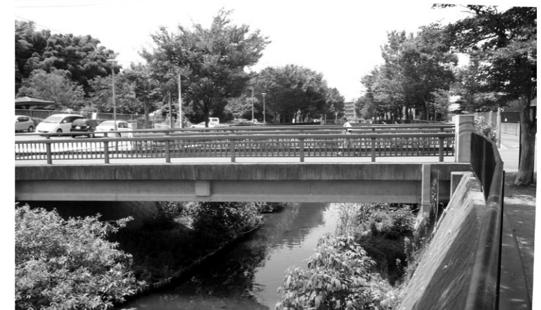
【河川改修後の小長谷橋】平成2年に架け替え橋長13mです。
