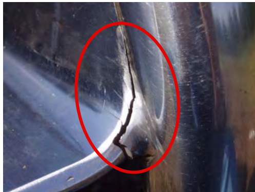
▲ 滑り降り部端部の亀裂
