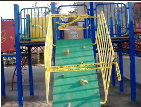
▲ 柵の破損（溶接部の折れ）
