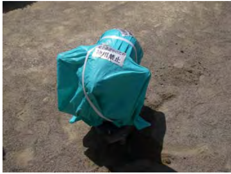
▲ 応急の使用禁止措置の事例
