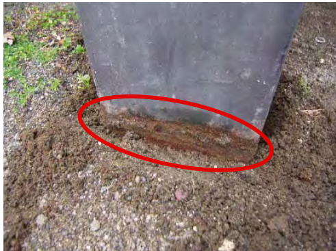
▲ 根際部の腐食（金属柱）
