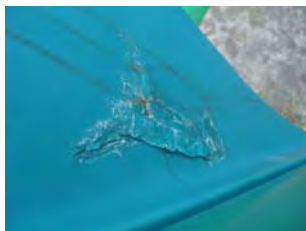
F R P の劣化状況
