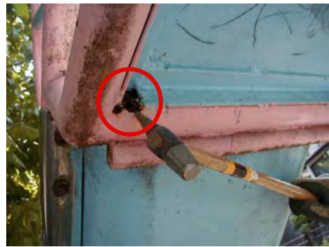
▲ 踊り場の腐食
