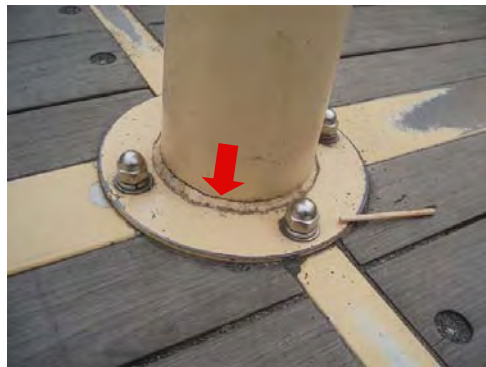
▲ フランジ溶接部の亀裂
