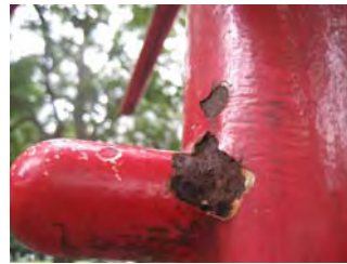
③腐食段階
