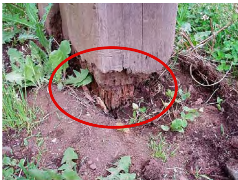
▲ 根際部の腐食（木製柱）
