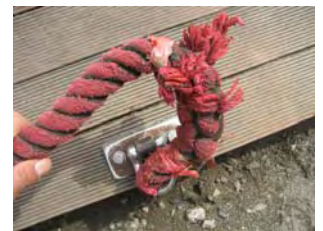
ロープ類の劣化状況
