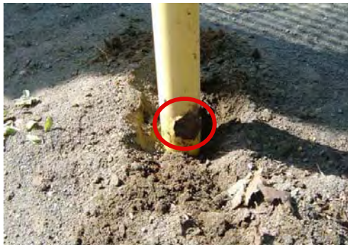
▲ 根際部の腐食（金属柱）
