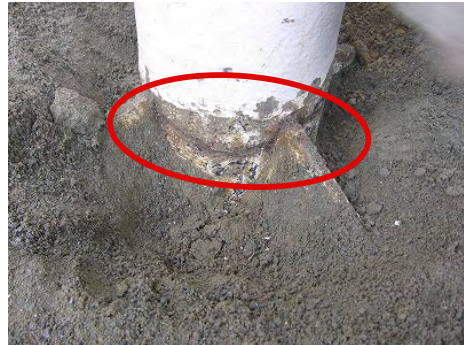
▲ 根際部の腐食及び亀裂
