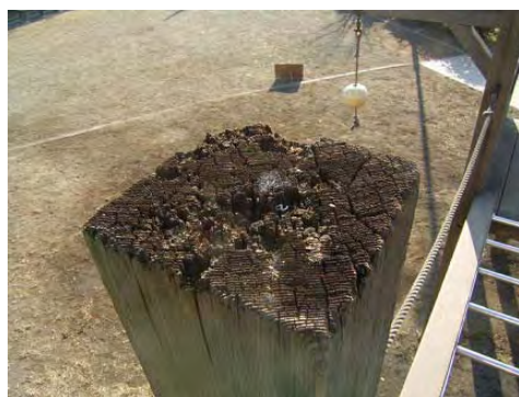
▲ 支柱天端の腐食
