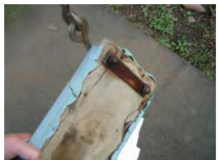
樹脂系素材の劣化状況
