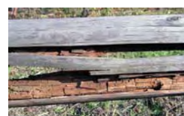
木材の腐朽 (褐色腐朽)
