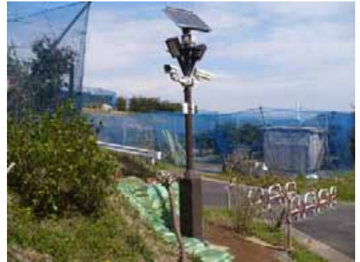
【写真】警報装置（金沢区）
