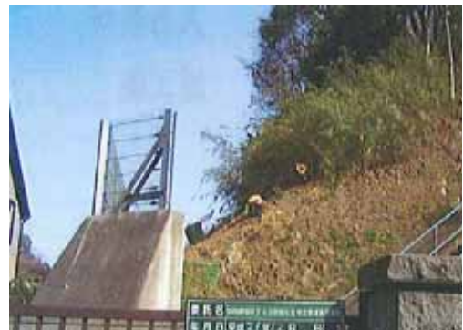
【写真2-2】再生・管理（施工後） 民家への危険がなくなりました。
