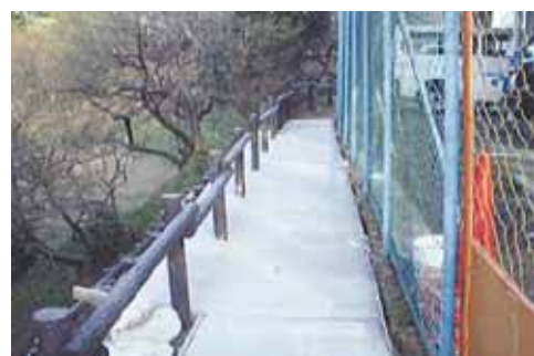
【写真3-2】危険斜面整備（施工後） 安全に通れるようになりました。
