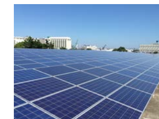
太陽光パネル (神奈川水再生センター)
