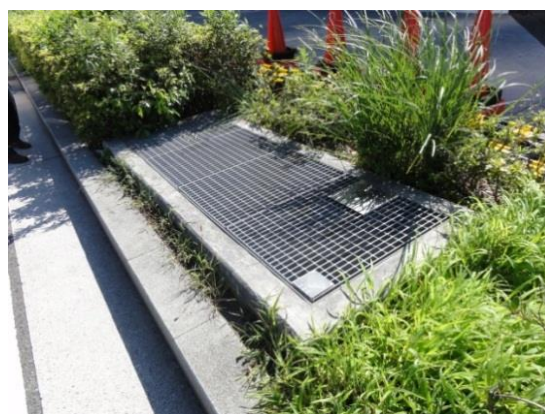
共同溝の換気口
