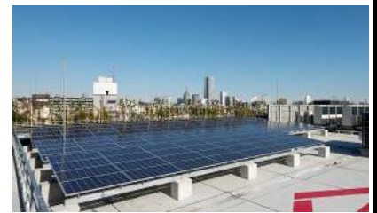
太陽光パネル(区役所屋上)
