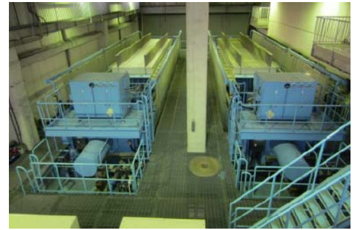
図 11 排水処理施設の主要設備（脱水機）
